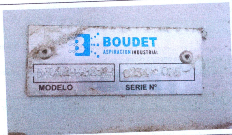
Detalles del sistema de filtración
