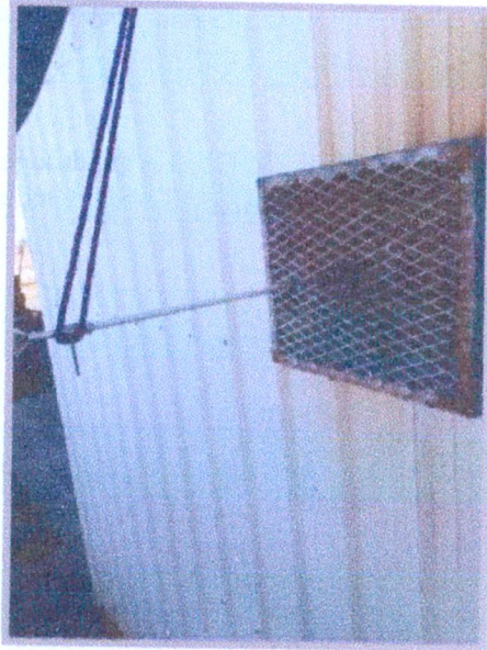
Chimenea de Horno
